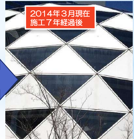
雨垂れの跡が未だに目立たない
